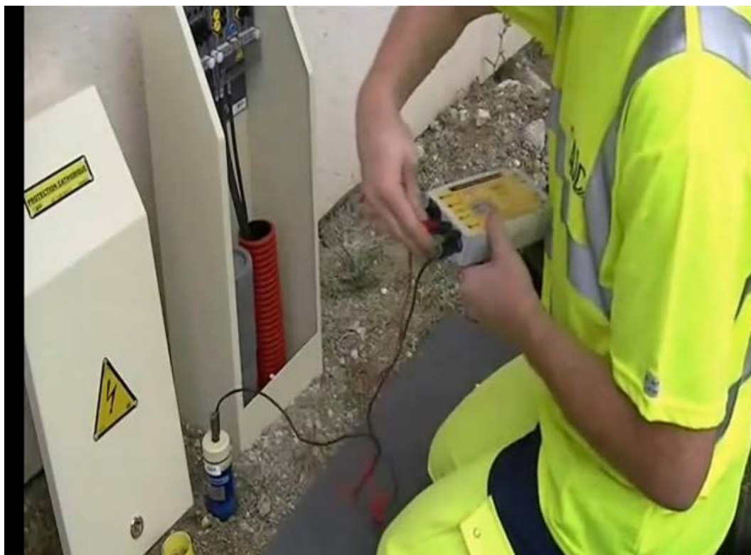
Branchement d'un Capteur de Protection Cathodique sur une électrode
